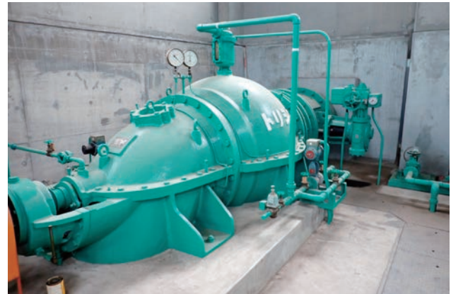
長年にわたり排水を続けてきた既設ポンプ
