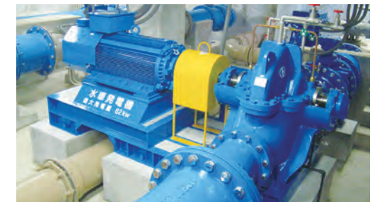
ポンプ逆転車(小水力発電)
