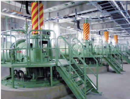
雨水排水ポンプ場
