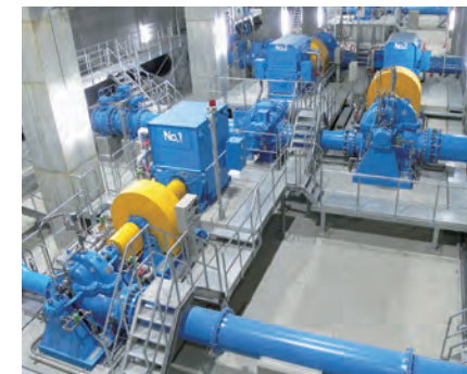
送水ポンプ設備
