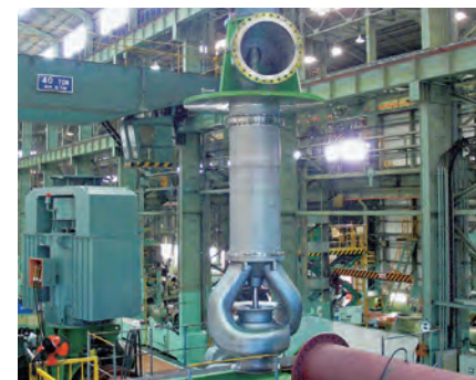
温水ポンプ(地熱発電プラント)
