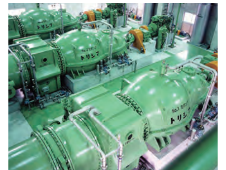
農業排水ポンプ場
