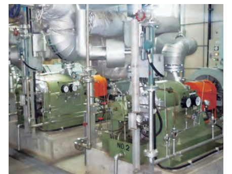
ボイラ給水ポンプ(ごみ処理場)
