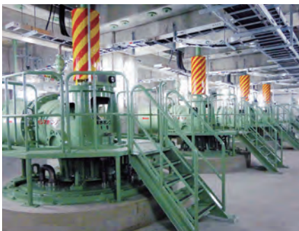
雨水排水ポンプ場
