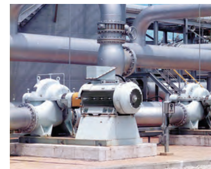
冷却水ポンプ(化学プラント)
