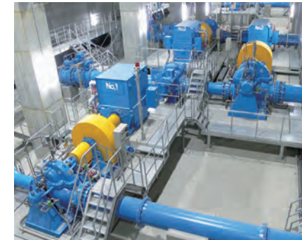
送水ポンプ設備
