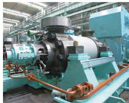
ボイラ給水ポンプ(火力発電プラント)
