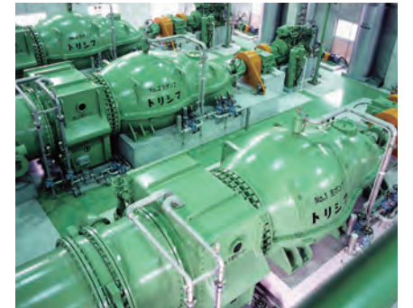
農業排水ポンプ場
