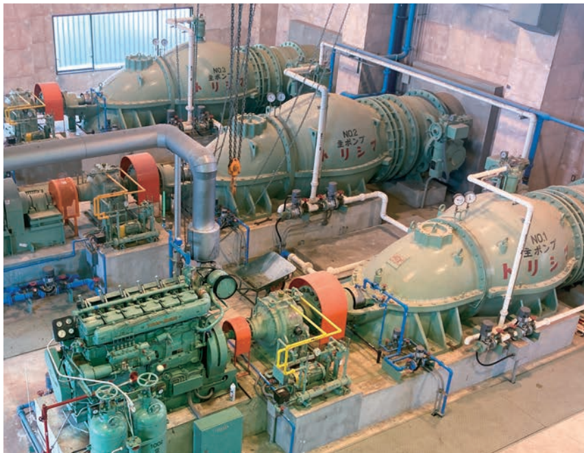
細谷排水機場 排水ポンプ(横軸斜流ポンプ)
