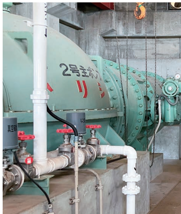
沢帯排水機場 排水ポンプ(横軸斜流ポンプ)
