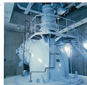
治水用可動翼排水ポンプ □ 径：2,400mm 原動機：1,103kW
