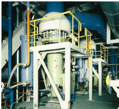
北海道電力(株) 苫東厚真発電所 (600MW)
