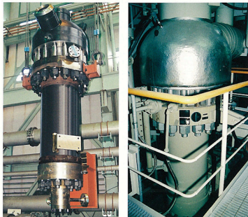
釜山コンバインドサイクル発電所 (500MW×4 units)
