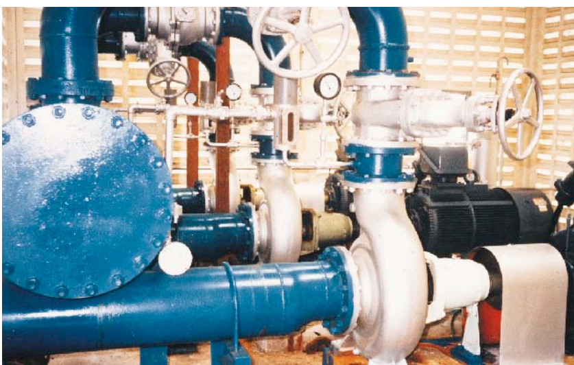
冷却水ポンプ／石油精製プラント
