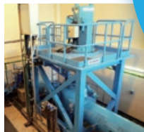
小水力発電システム (立軸ポンプ逆転車)
