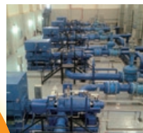
上水道用 送水ポンプ場
