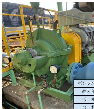
▲両吸込渦巻ポンプ (圧延系高圧給水ポンプ)
