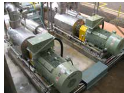
メインのボイラ給水ポンプ2台。ポンプ部分は高温のためカバー(銀色の部分)がかけられている。
