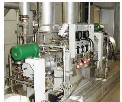
ボイラ給水ポンプである多段高圧ポンプ
