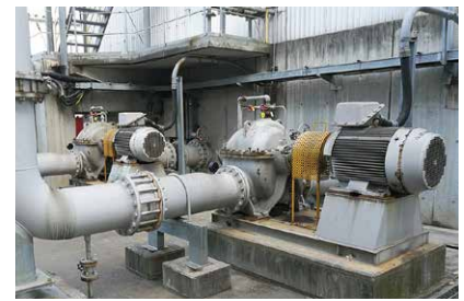
循環水ポンプである横軸面吸込みポンプ
