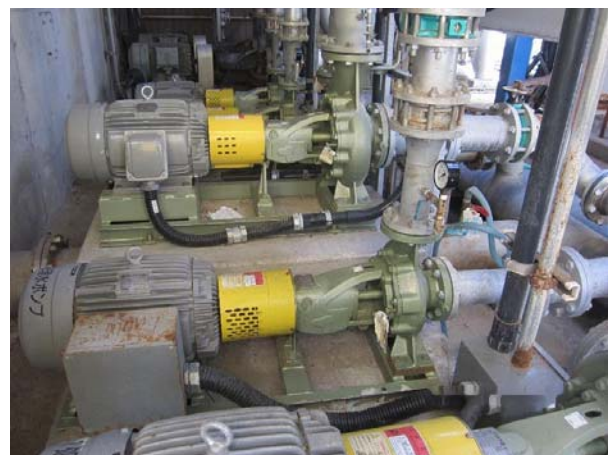
▲処理水の排水ポンプ
