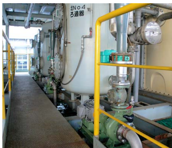
▲ 工業用水濾過装置用ポンプ
