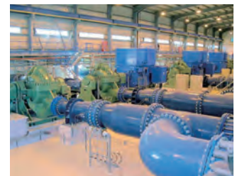
Насосная станция передачи питьевой воды на большое расстояние (140 км) ОАЭ
