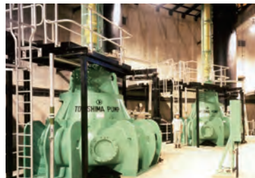
Насосной станция передачи сточных вод Гонконг
