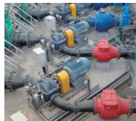
Насосная станция распределяющая питьевой воды Катар
