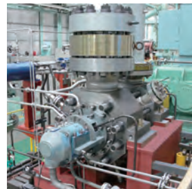
Питательный насос котла типа кольцо
