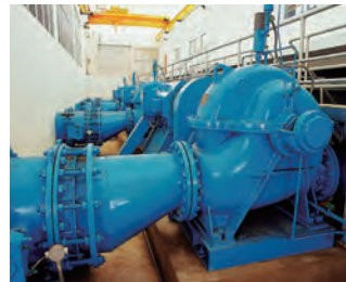
Усилительная насосная станция питьевой воды Индонезии
