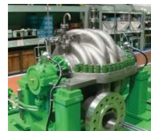
RO高圧海水供給ポンプ
