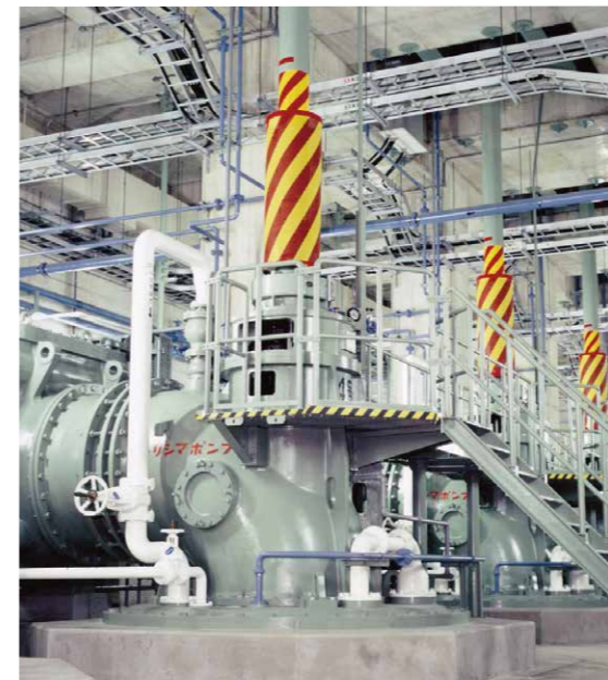
[立軸斜流ポンプ]
