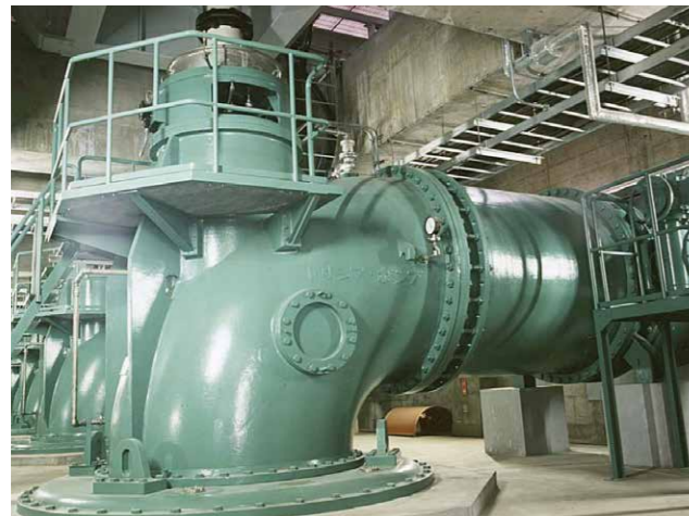
[立軸斜流ポンプ]
