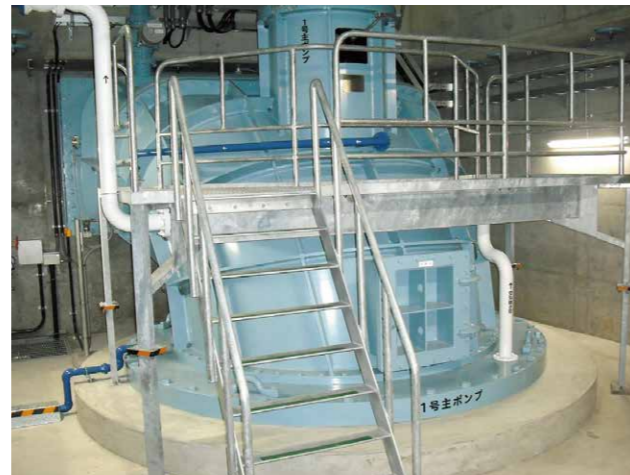
[立軸軸流ポンプ]
