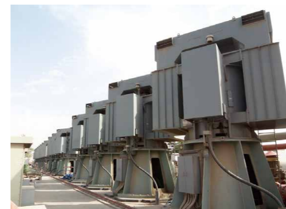
[立軸斜流ポンプ]
