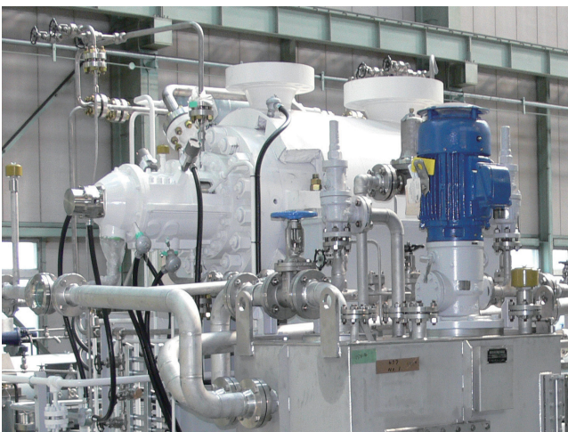
サウジアラビア MHB ボイラ給水ポンプ
