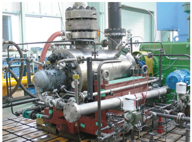
メキシコ MHB ボイラ給水ポンプ
