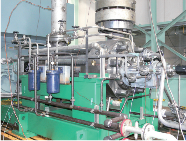
アラブ首長国連邦 (UAE) MHG ボイラ給水ポンプ
