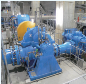
送水ポンプ場
