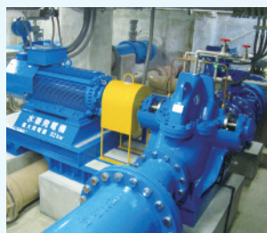
ポンプ逆転水車
