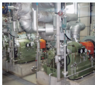
清掃工場用 ボイラ給水ポンプ
