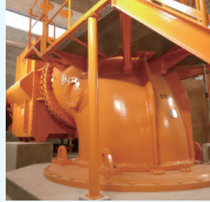
河川排水ポンプ場
