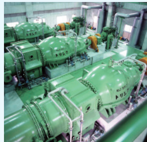
農業排水ポンプ場
