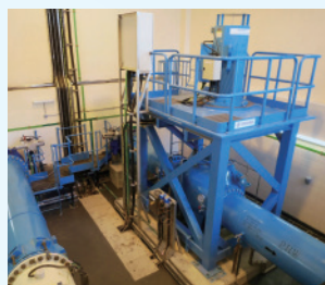
立軸ポンプ逆転水車
