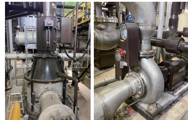
循環水ポンプ
