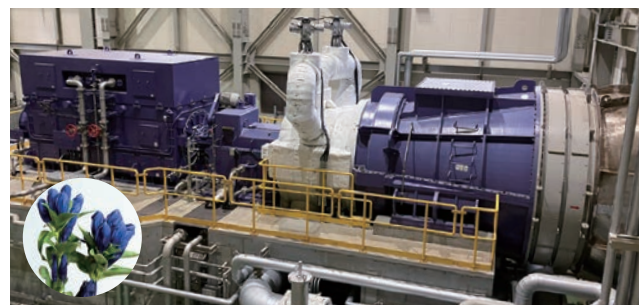
こだわりの「リンドウ色」で彩られた発電機とタービン
