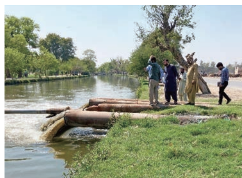
ポンプの実排水運転
