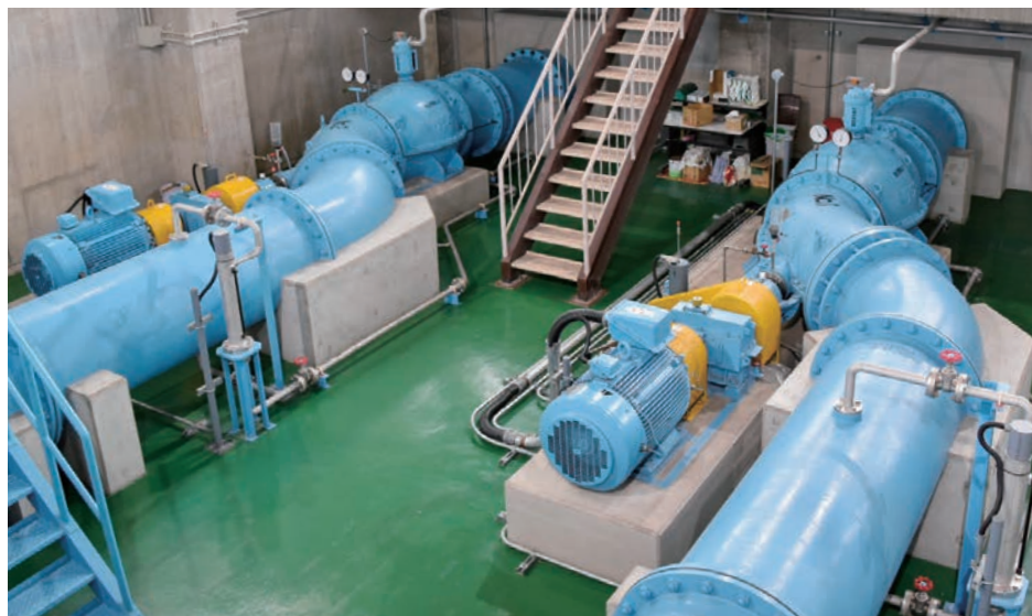
常時排水ポンプ
