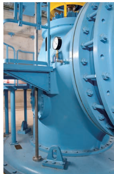
洪水時排水ポンプ
