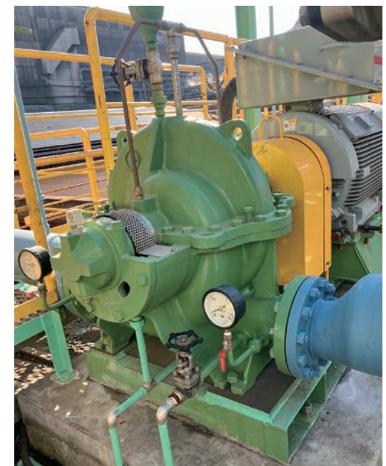
圧延系高圧給水ポンプ
