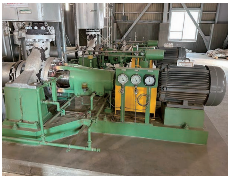
インペラカットした缶水循環ポンプ
