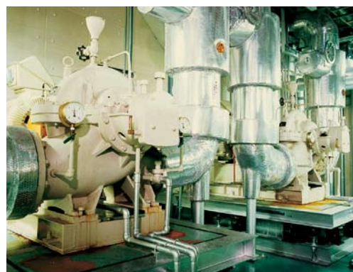
地域冷暖房設備での冷却水循環ポンプ
