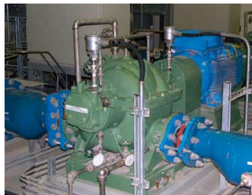
海水淡水化プラントでの飲料水送水ポンプ
