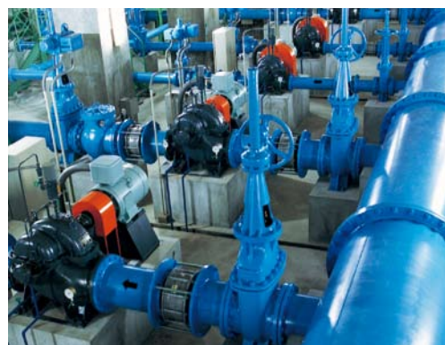
上水道設備での配水ポンプ
