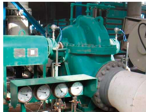
発電所での冷却水ポンプ
