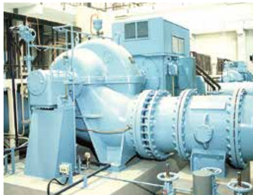
かんがい用ポンプ CDM800×600mm, 4,200m 3 /h, 60m, 900kW
