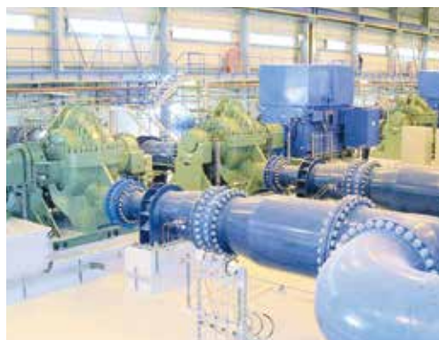
飲料水送水用ポンプ CDM800×500mm, 4,740m 3 /h, 250m, 4,700kW
