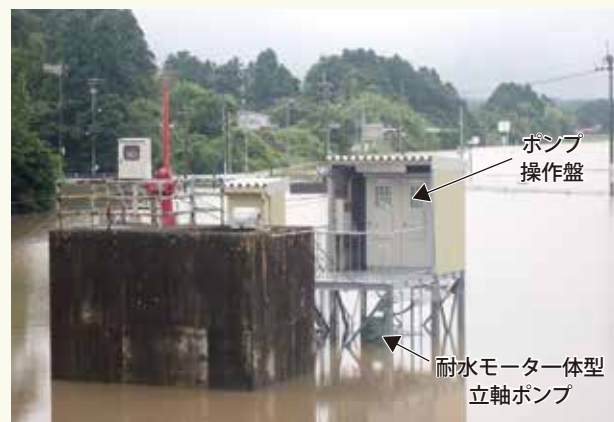
写真③ 2022年7月の浸水状況
