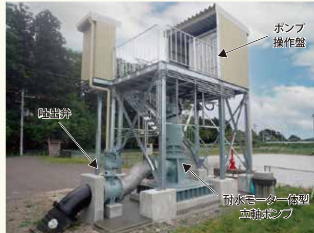
写真② 機場全体の耐水化を実現した後谷地排水機場
