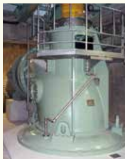
整備されたNo.1主ポンプ
