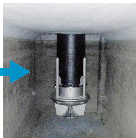
吸水槽内の吸込み管（渦対策機構付き）
