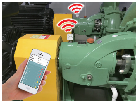
ポンプへのセンサ設置例
