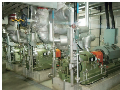
清掃工場でのボイラ給水ポンプ
