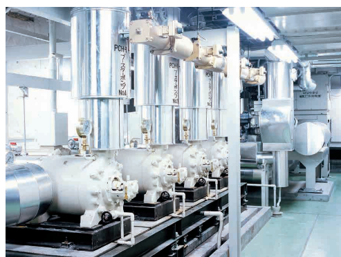
ビル設備での給水ポンプ
