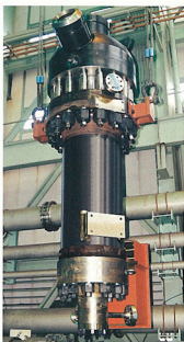
釜山コンバインドサイクル発電所 (500MW × 4units)
