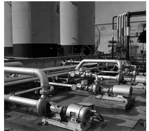
▲油槽所でのガソリン移送用
