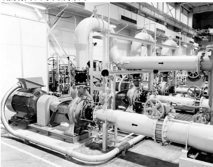
▼原子カプラントでの冷却水ポンプ
