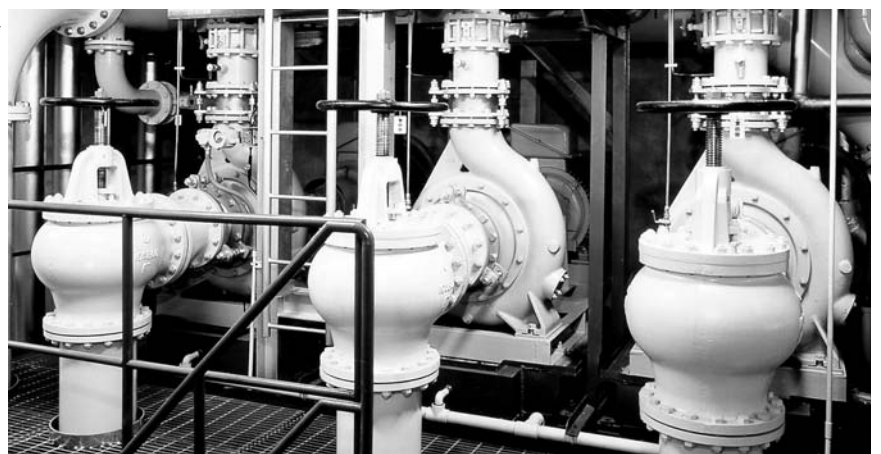
◀地域冷暖房設備での冷水ポンプ
