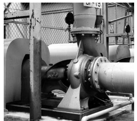
▲自動車工場での冷却水ポンプ
