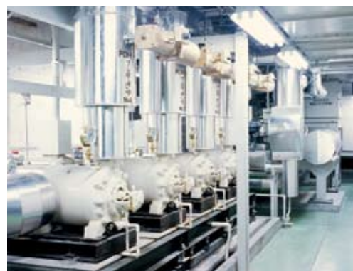
ビル設備での給水ポンプ
