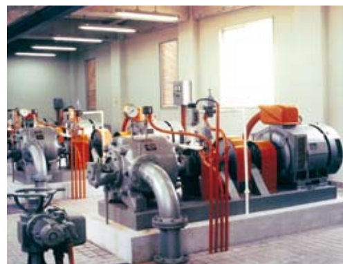
簡易水道設備での送水用ポンプ
