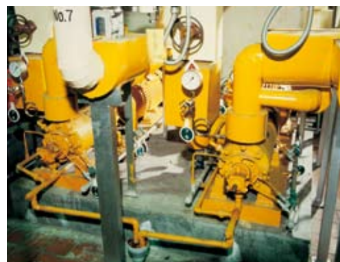
地域冷暖房設備でのボイラ給水ポンプ
