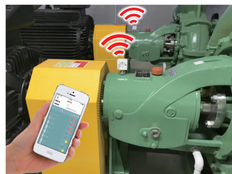
ポンプへのセンサ設置例
